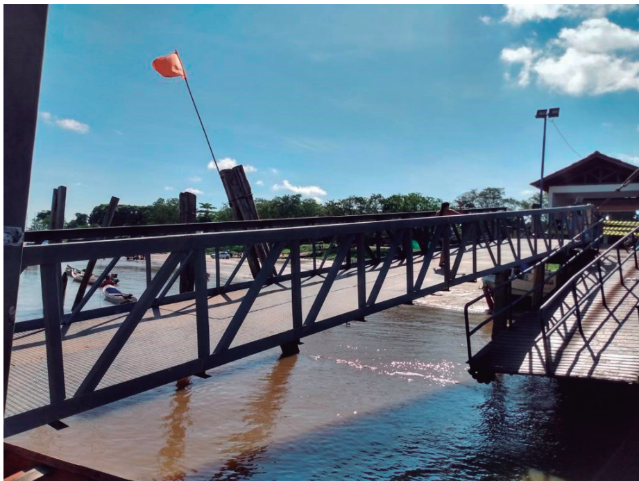
Figura 2 - Ponte de embarque e desembarque, antes da reforma
