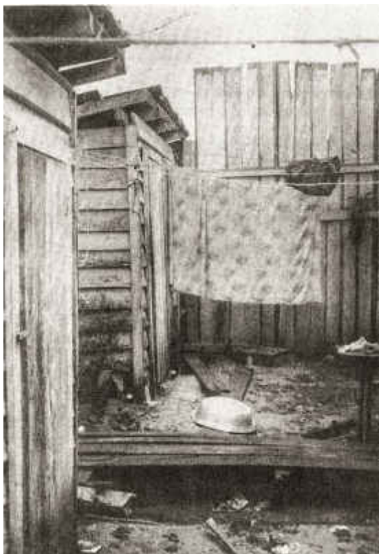
Foto 6 - Banheiros da Vila de Transição cujos terrenos estão cedendo, Conjunto Providência. Agosto/1980.
