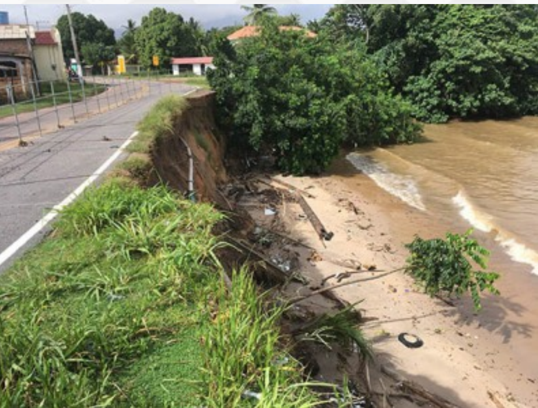
Foto 17. Estrada em Ponta de Pedras danificada pelas fortes marés, devidas ao aumento do nível do mar. Fonte: L. Pereira
