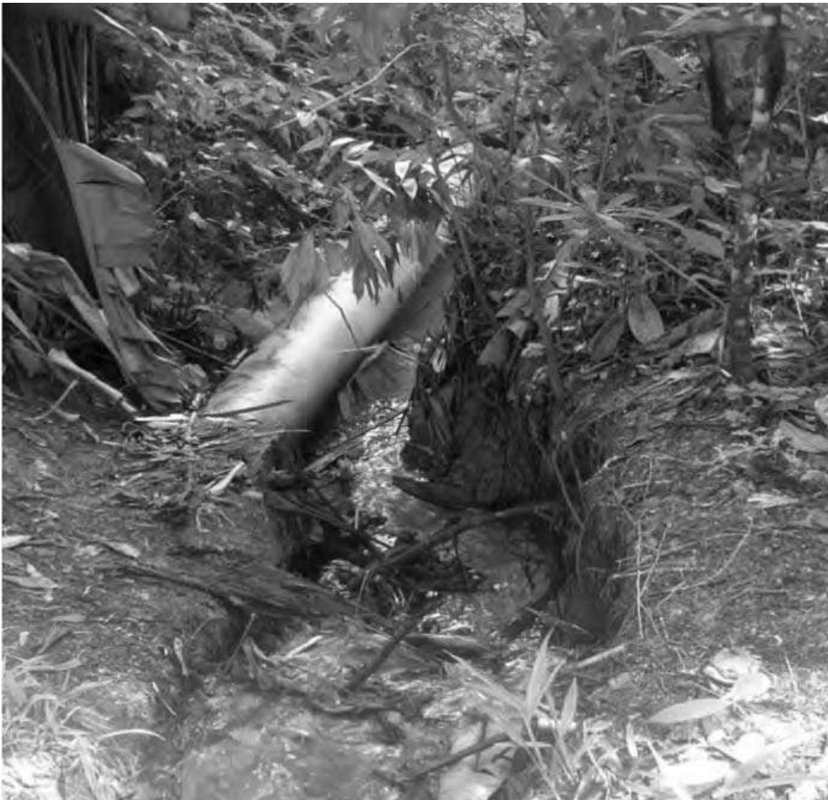
Fotografia 40 - Tubulação despejando esgoto dentro da área do PEUt.
